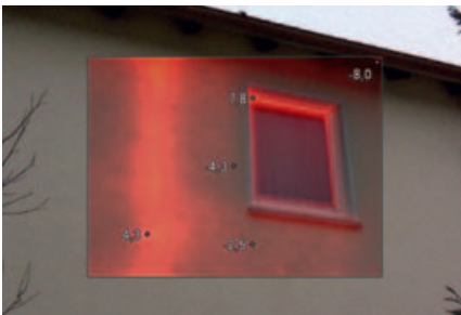
Temperaturmessung zur Feststellung von Wärmeverlusten in einer Hausfassade.
